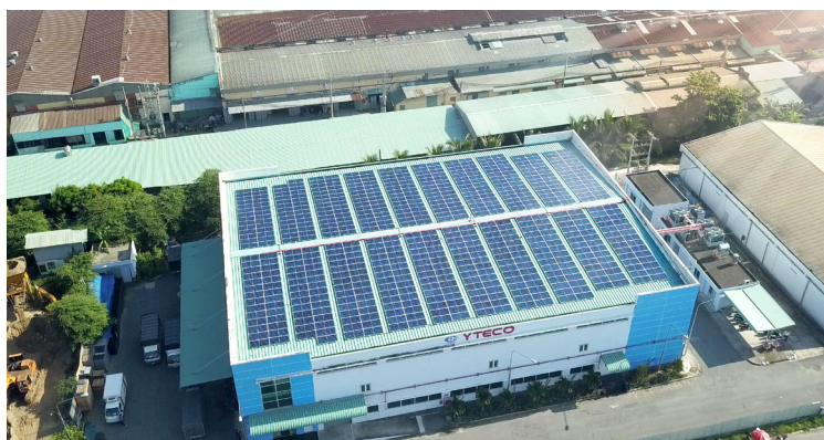
Công Ty Yteco – Hồ Chí Minh - Công suất 200 kWp
