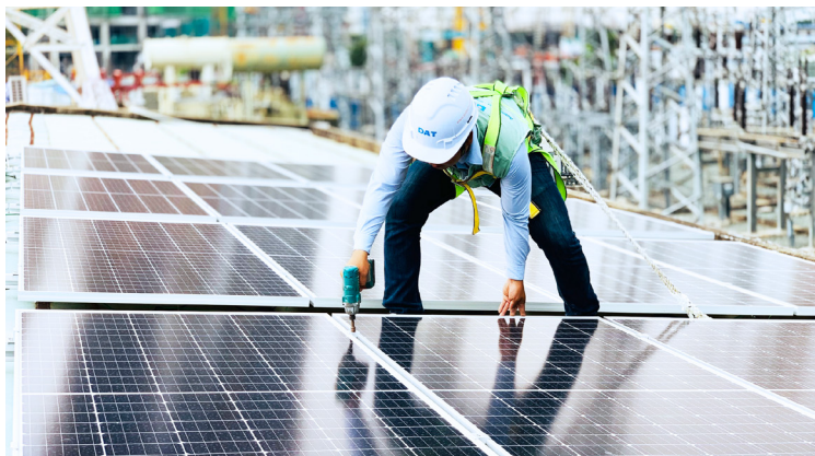
Công Ty Lưới Điện Cao Thế HCM (41 Trạm) Công suất 1.8 MWp
