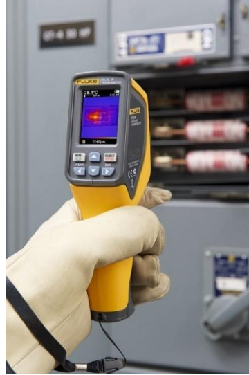
Kiểm tra nhiệt độ tủ điện bằng camera nhiệt
