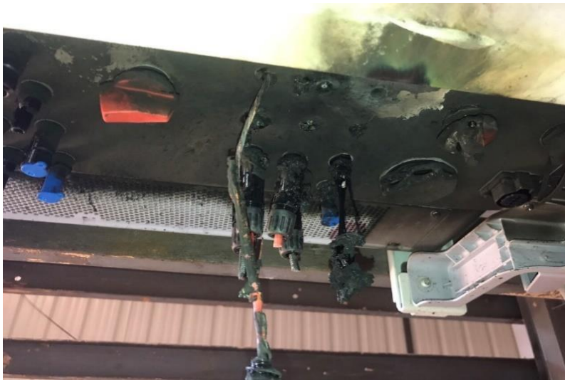
Inverter bị cháy do sự cố chập chập dây DC
