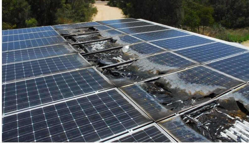
Các tấm pin bị cháy do chập điện
