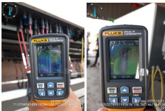
Kiểm tra nhiệt độ hoạt động của inverter
