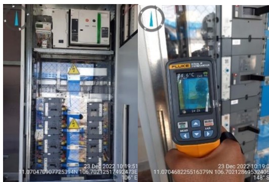
Kiểm tra nhiệt độ tủ điện DB Solar
