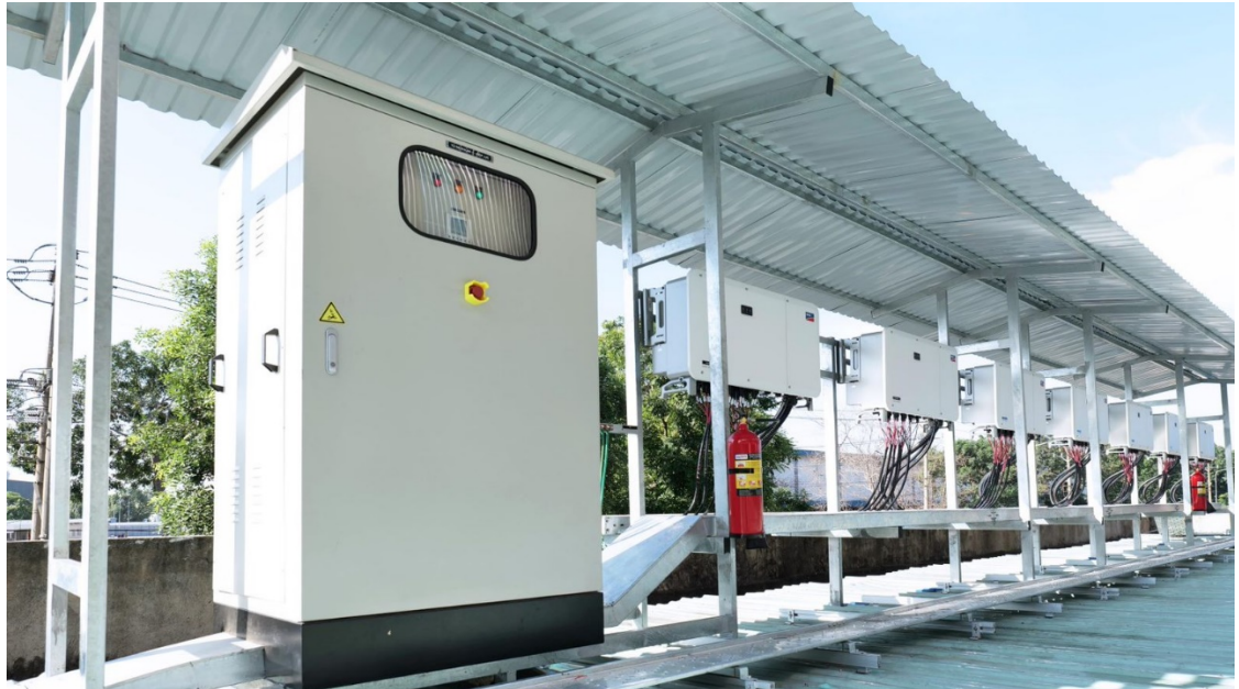
Hình ảnh khu vực nhà inverter
