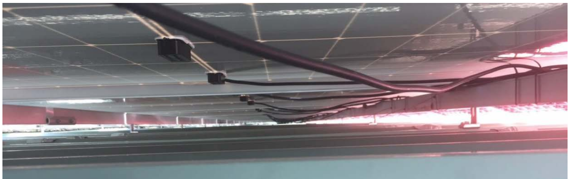
Dây DC tấm pin được cố định lên khung ray nhôm
