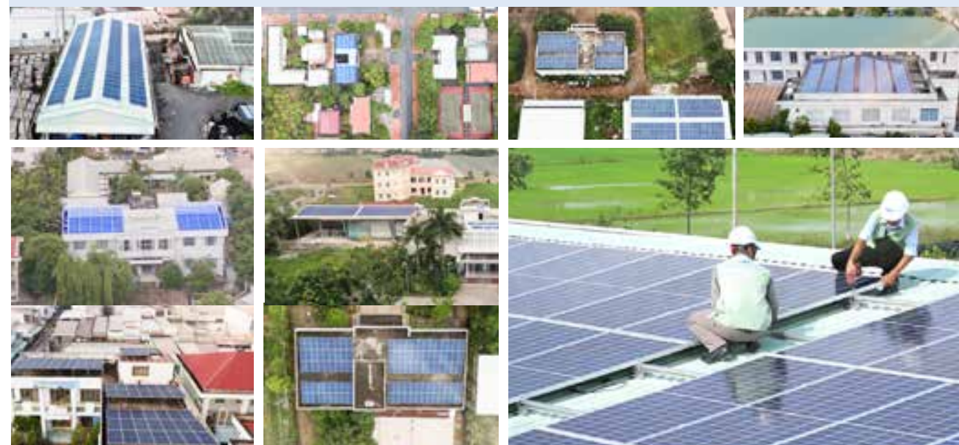
Tại 9 hệ thống điện mặt trời cho Công ty Điện lực Cần Thơ Tổng công suất: 324,8kWp Ngày hoàn thành: T7/2019
