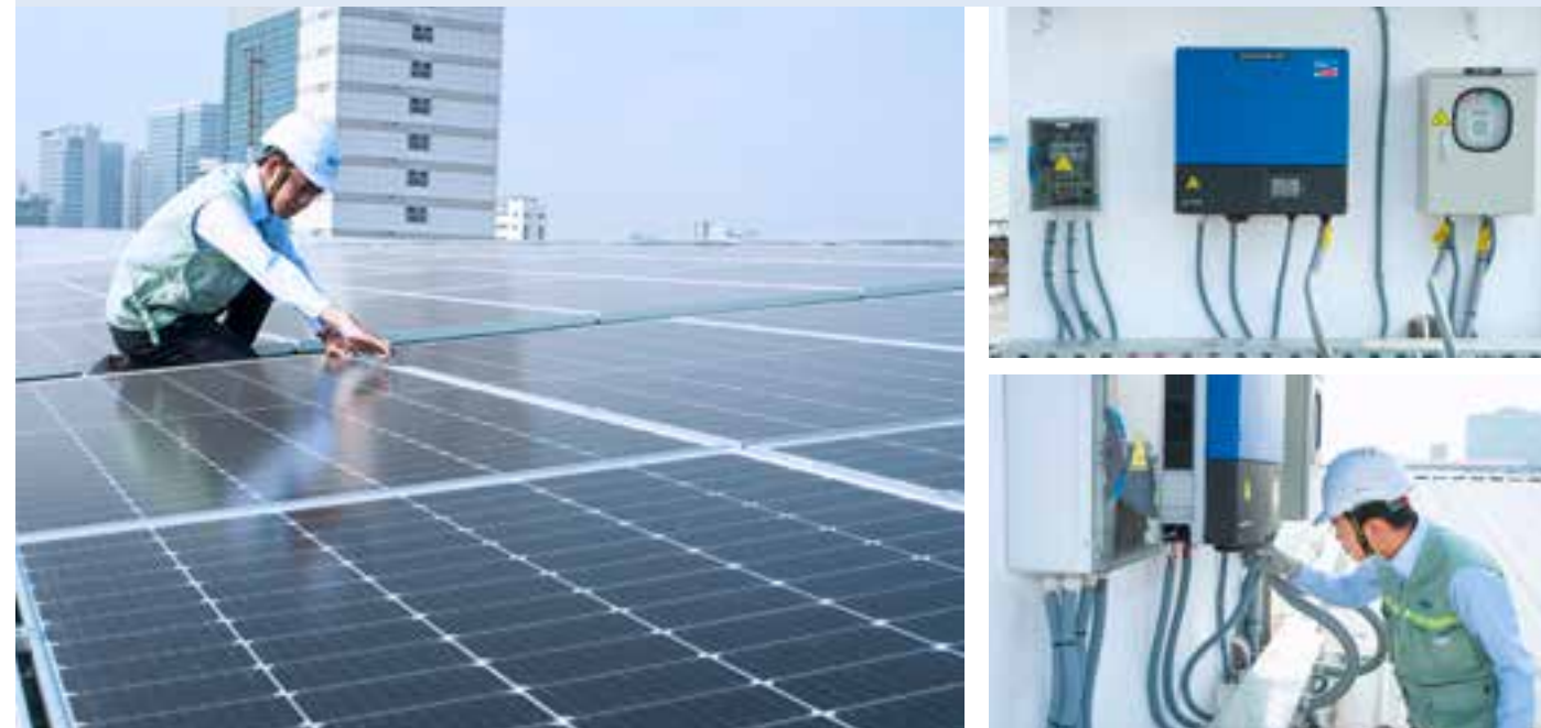
Tại Sở Công thương và UBND Quận 3 Tổng công suất: 50kWp Ngày hoàn thành: T1/2021
