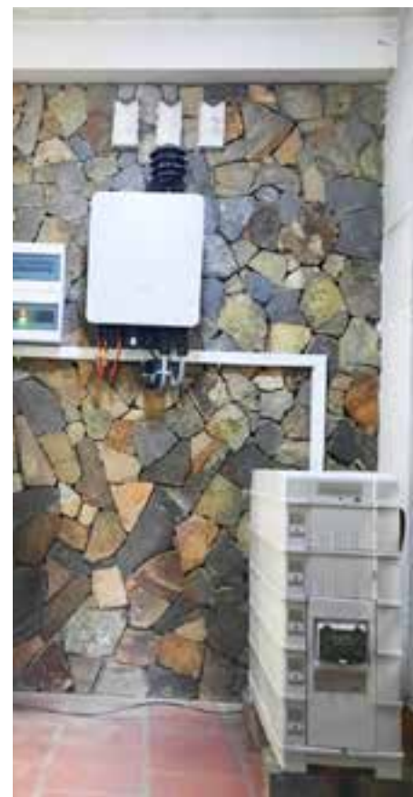
Hệ thống Hybrid Sungrow 10kW 3 pha Battery Sungrow SBR 16kWh
