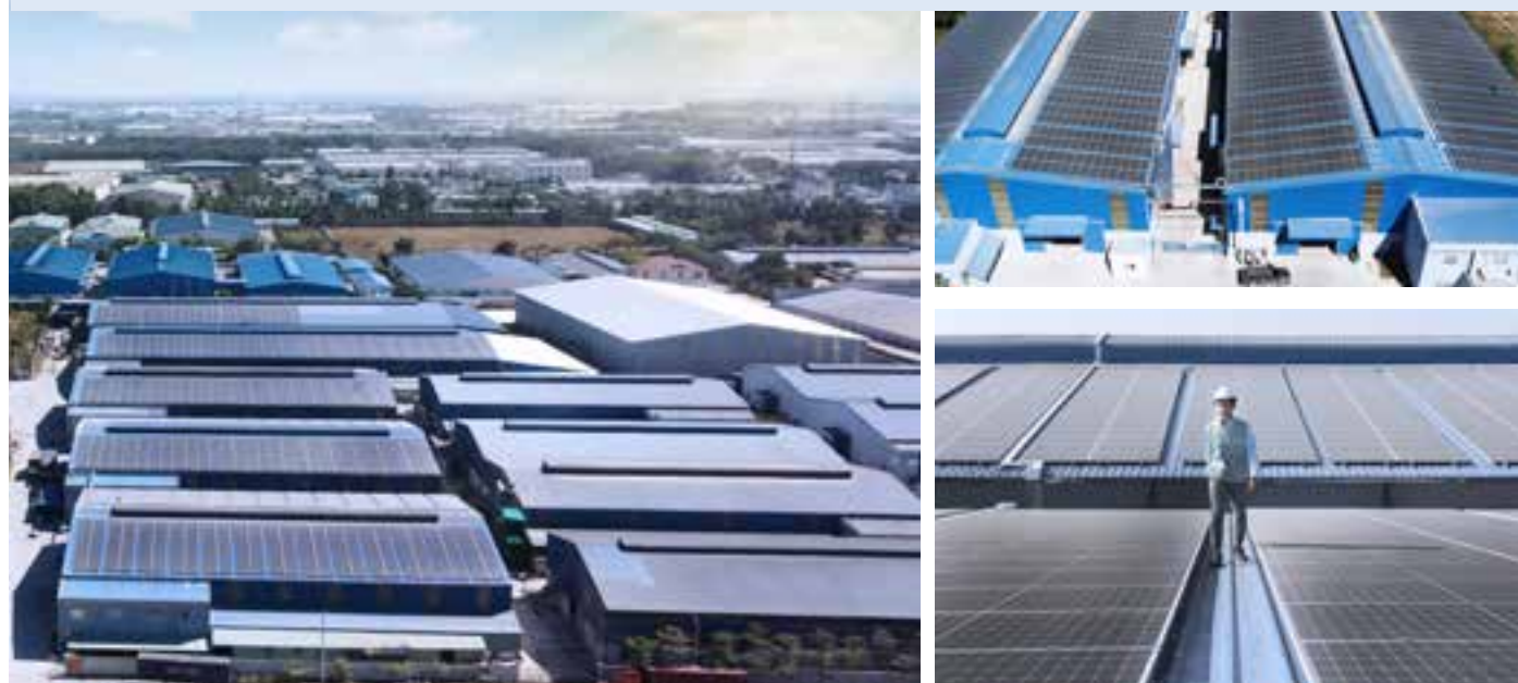
Tại Công Ty TNHH Phong Thanh Phát, Bình Dương Công suất: 3MWp Ngày hoàn thành: T1/2021
