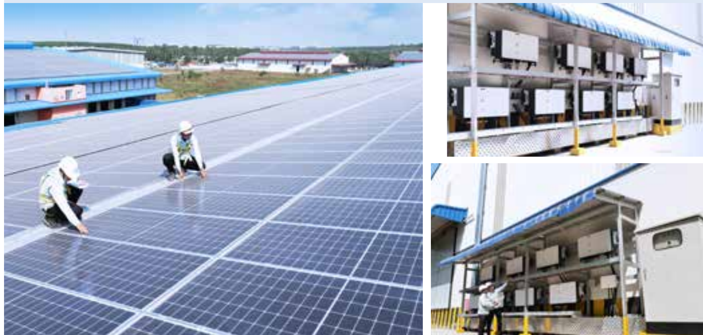
Tại ICD Tân Cảng - Long Bình, Đồng Nai Công suất toàn hệ thống: 19MWp DAT Solar tổng thầu EPC: 8MWp Ngày hoàn thành: T1/2021
